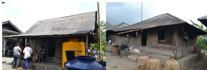
Gambar 14 dan 15. Perubahan bentuk atap dan penggunaan seng sebagai material penutup atap
